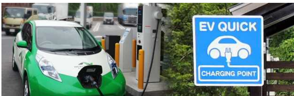
高速道路 SA の EV 急速充電スタンド (NEXCO 東日本)
