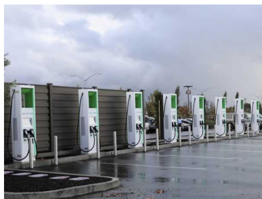
350kW で EV を複数台充電できる設備（米国）
